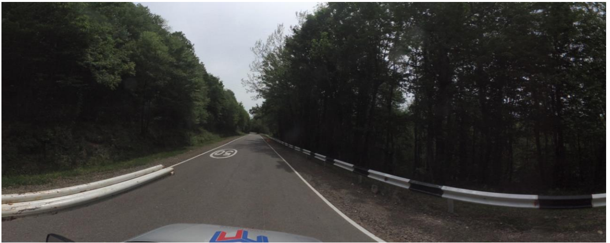
Рисунок 1.4.5 – Состояние дорожного покрытия а/д 03 ОП МЗ 03Н-518 «с. Шаумян - х. Терзиян» на момент обследования
