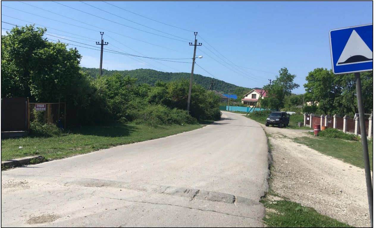
Рисунок 1.7.9 – Пример эксплуатационного состояния ИН монолитной конструкции, не соответствующей нормативным требованиям, расположенной по ул. Кооперативная в с. Тенгинка
