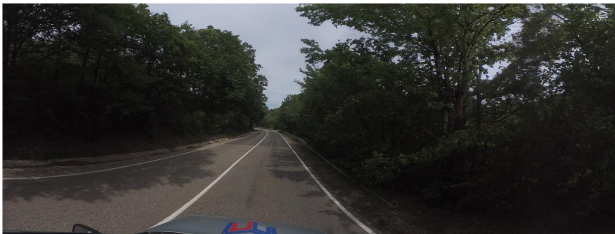
Рисунок 1.4.1 – Состояние дорожного покрытия а/д 03 ОП РЗ 03К-003 «г. Майкоп – г. Туапсе» на момент обследования
