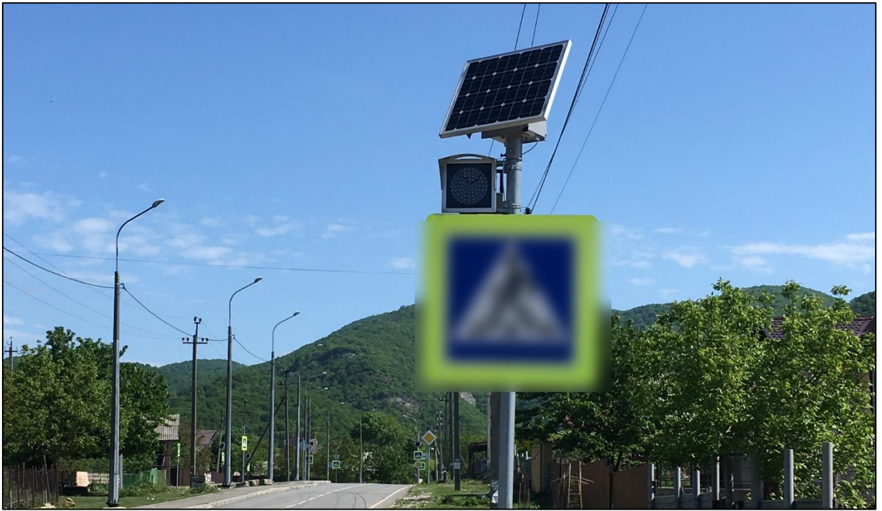
Рисунок 1.7.2 – Пример эксплуатационного состояния светофора Т.7, расположенного по ул. Персиковая, с. Тенгинка
