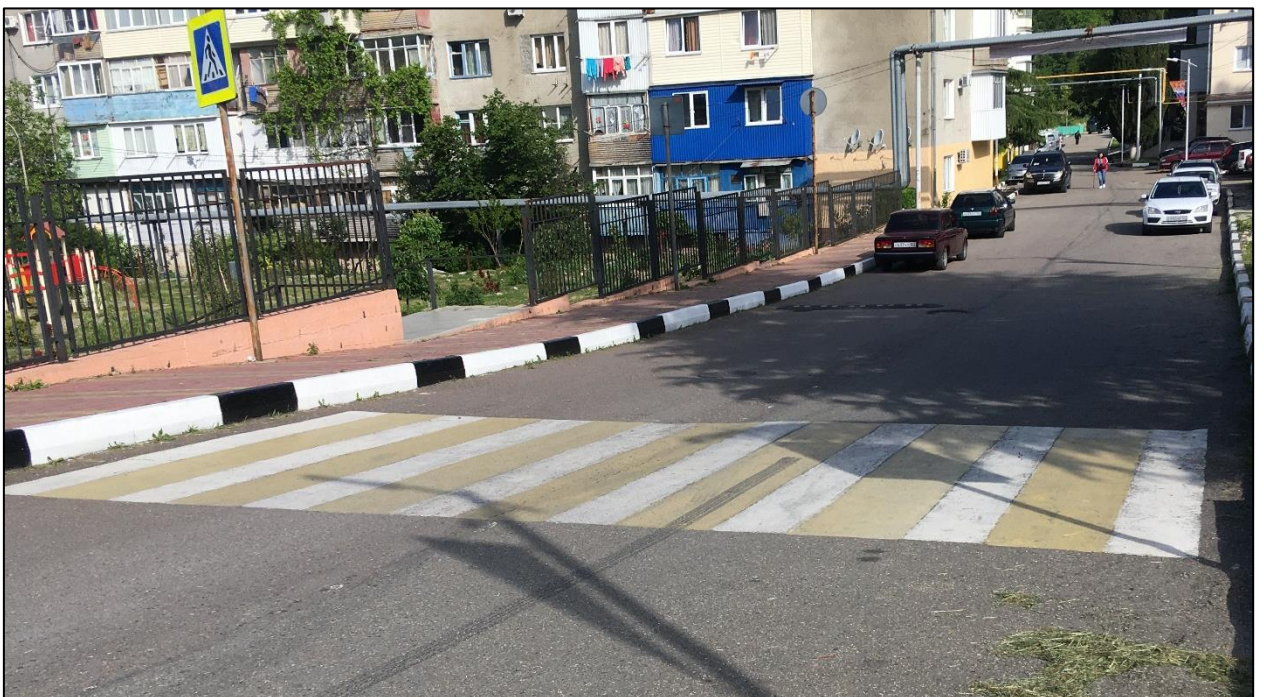
Рисунок 1.7.6 – Пример эксплуатационного состояния горизонтальной разметки 1.14.1 (обозначающей пешеходный переход) нанесённых по ул. Садовая в с. Шепси
