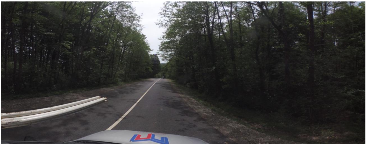
Рисунок 1.4.6 – Состояние дорожного покрытия а/д 03 ОП МЗ 03Н-518 «с. Шаумян - х. Терзиян» на момент обследования
