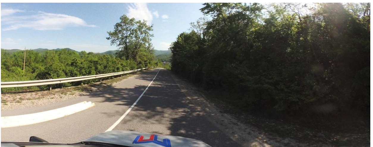
Рисунок 1.4.8 – Состояние дорожного покрытия а/д 03 ОП РЗ 03К-520 «Подъезд к с. Тенгинка» на момент обследования
