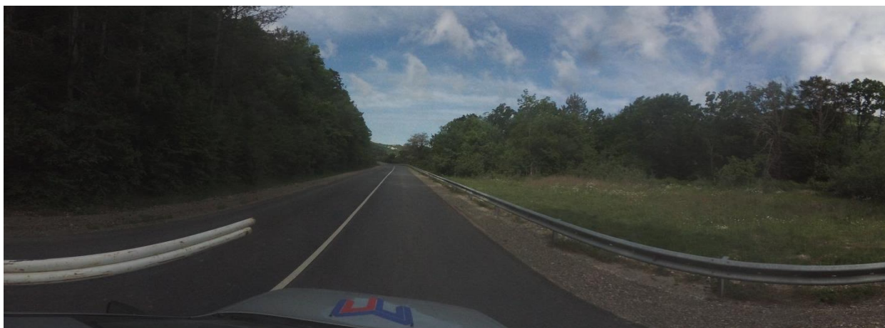
Рисунок 1.4.9 – Состояние дорожного покрытия а/д 03 ОП РЗ 03К-521 «пгт. Новомихайловский – а. Псебе» на момент обследования
