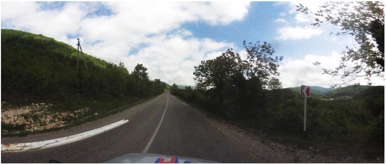
Рисунок 1.4.13 – Состояние дорожного покрытия а/д 03 ОП РЗ 03К-523 «Подъезд к а. Агуй-Шапсуг» на момент обследования
