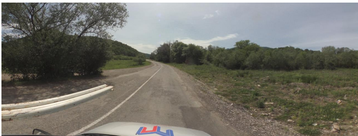
Рисунок 1.4.3 – Состояние дорожного покрытия а/д 03 ОП РЗ 03К-516 «с. Георгиевское – а. Большое Псеушхо» на момент обследования
