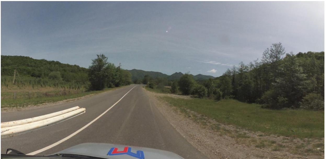
Рисунок 1.4.4 – Состояние дорожного покрытия а/д 03 ОП РЗ 03К-517 «с. Георгиевское - с. Анастасиевка» на момент обследования
