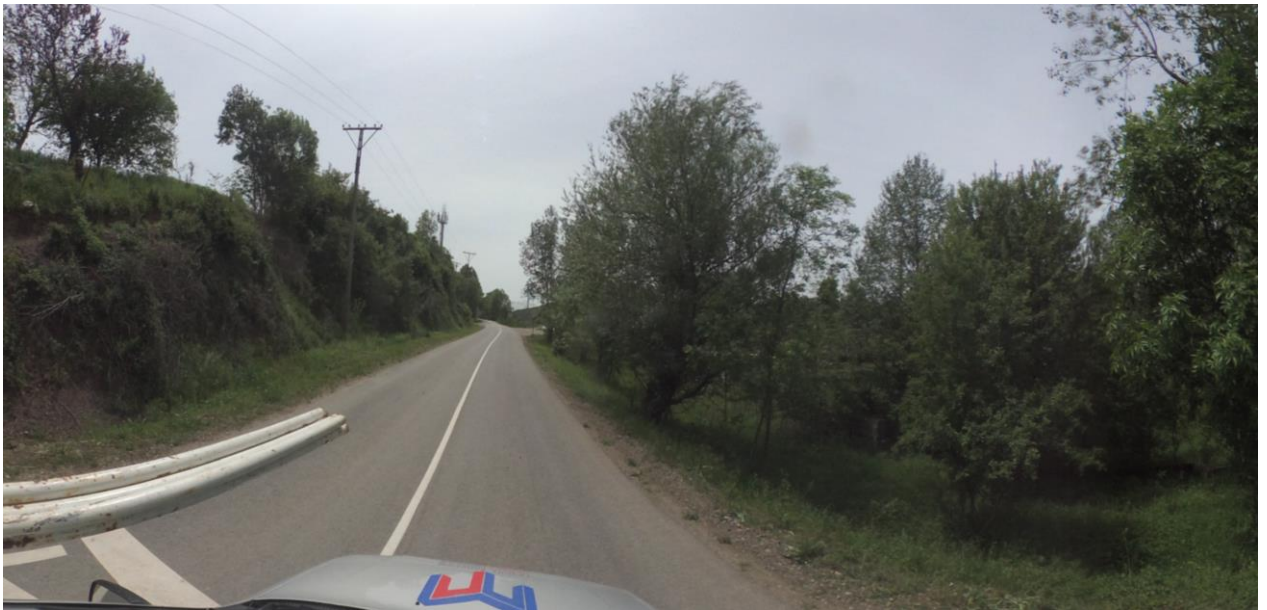
Рисунок 1.4.12 – Состояние дорожного покрытия а/д 03 ОП РЗ 03К-522 «п. Октябрьский – с. Гунайка Четвертая» на момент обследования
